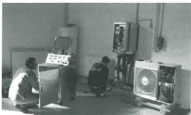
Mise en service d'une pompe à chaleur
