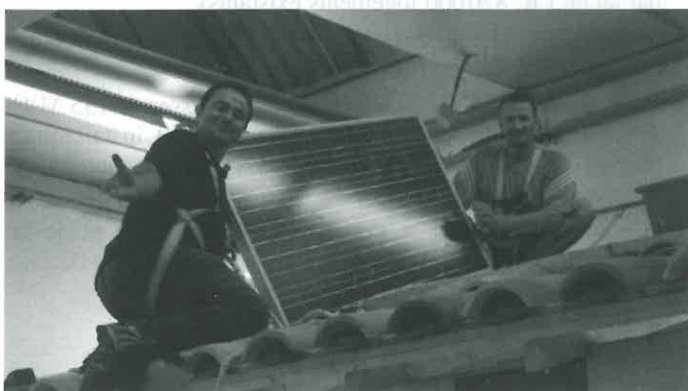
Intégration de capteur PV en toiture
